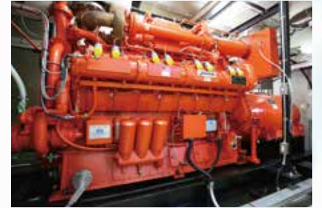
ガスエンジン発電機
